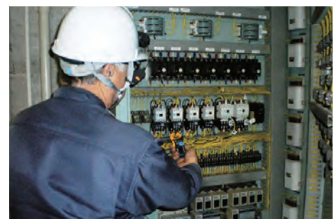
電気設備点検
